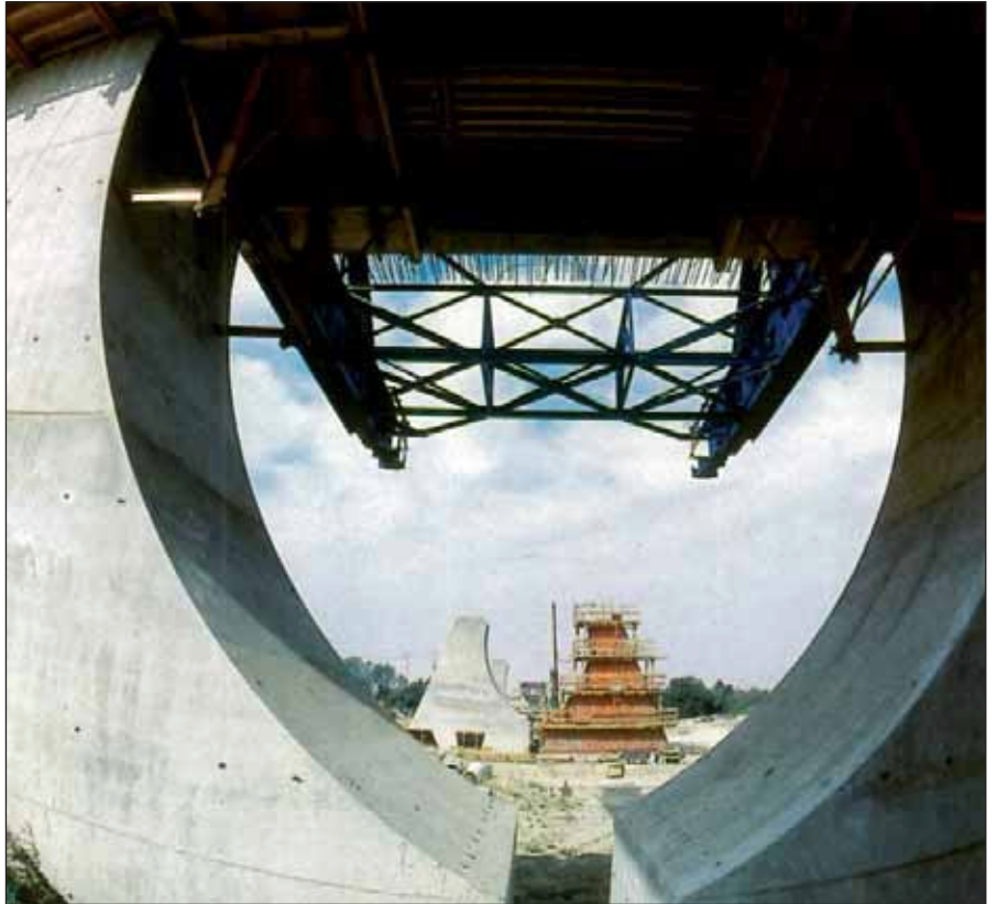
Avanzaban las obras en las nuevas líneas de alta velocidad como la Madrid-Barcelona.
