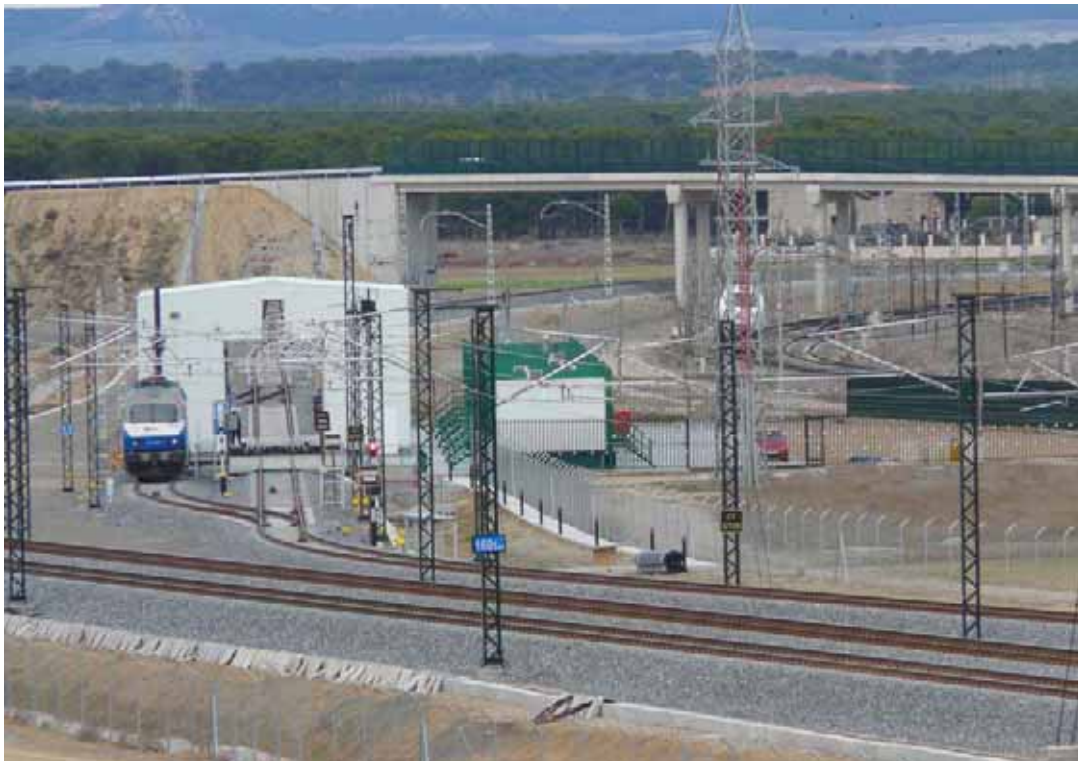
Vista general del cambiador de Valdestillas, Valladolid. (Foto: Sara Izquierdo)
