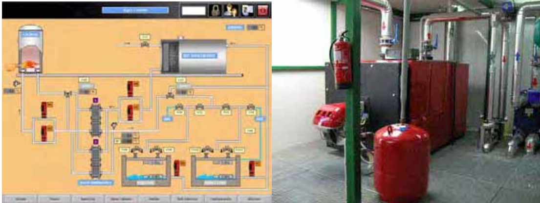
A la izquierda, sistema de control de agua caliente y a la derecha vista general de caldera
