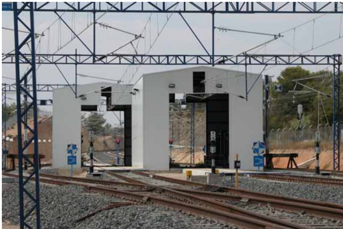
En Roda de Bará (en la foto) y en Antequera, los cambiadores son dobles, lo que permita cambiar el ancho simultáneamente a los trenes que circulan en sentido contrario
