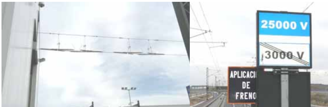
A la izquierda, seccionadores aéreos a la entrada del cambiador. A la derecha, la señal muestra que cambia la tensión de electrificación
