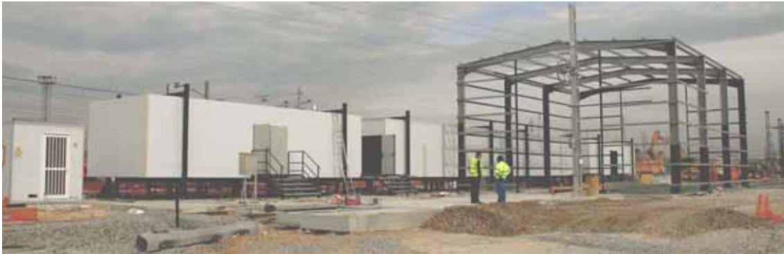
Junto a los cambiadores de tercera generación se construyen módulos trasladables en los que se ubican los equipos auxiliares
