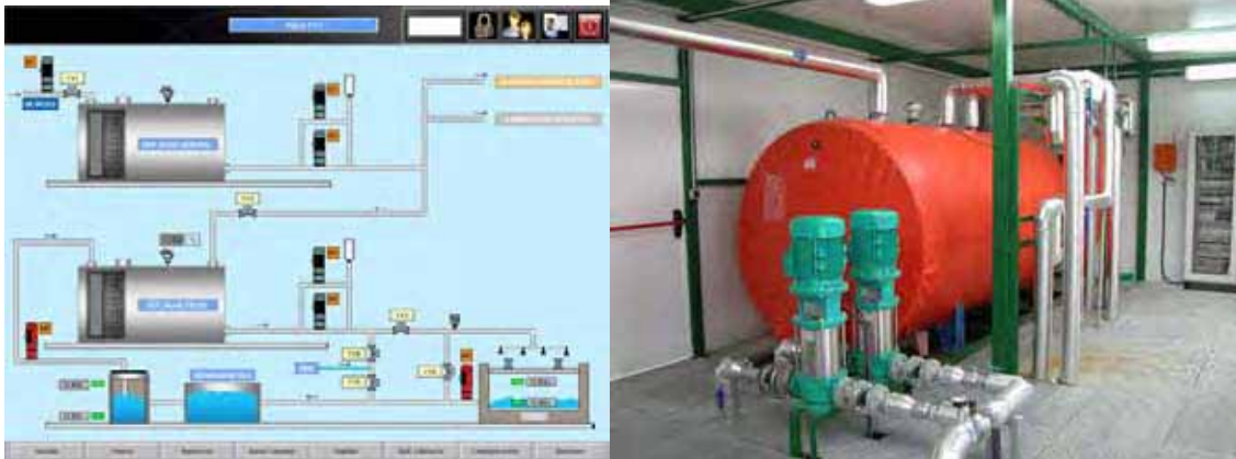
A la izquierda, sistema de control; y a la derecha, vista general instalación de agua
